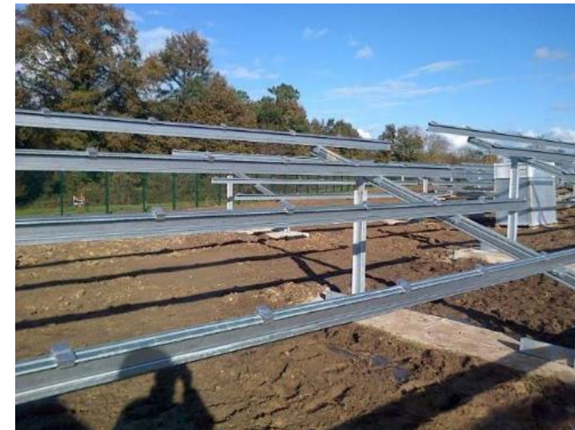
Figure 53 : Exemple de chantier de construction – Pose des structures (Source : (Crédit photo : SERGIES, 2015))
